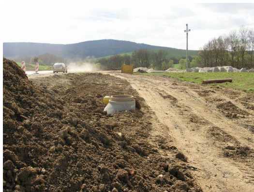
Kanalizace (zdroj Internet)
